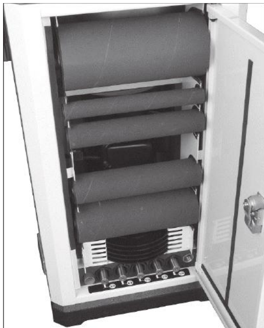
Figure 3 : stockage de l'armoire
